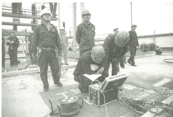
施工人员在给新装变压器做试验
